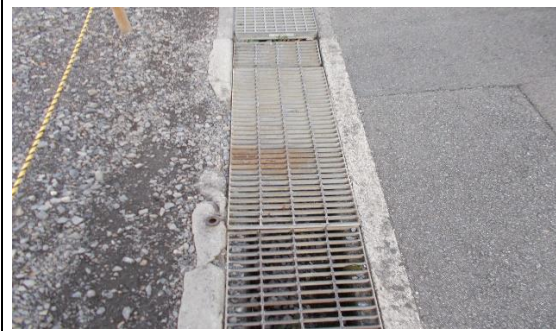
浮き沈みしているグレーチングの状況
