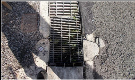
沈んでいるグレーチングの状況
